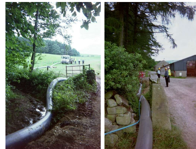
厳しい環境下での敷設例
